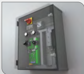
Armoire IP65* déportée positionnée à l'extérieur de la chambre froide, côté positif
